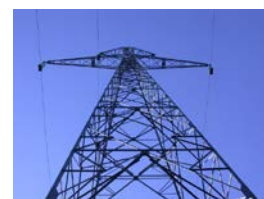
Les tours électriques utilisent des isolants en porcelaine pour supporter les fils électriques ce qui « isole » les fils de la mise à la terre située au sol.
